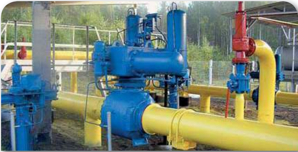
Запорная арматура Оханской ГКС, ООО «Газпром трансгаз Чайковский»
