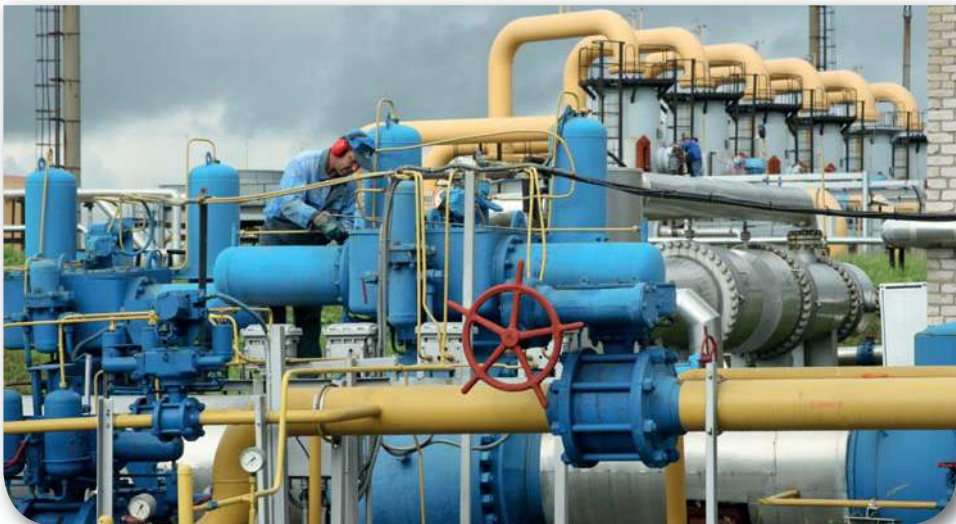
Технологическое оборудование компрессорной станции
